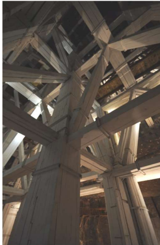
Rys.1 Drewniana obudowa o geometrii kratownicowej w wyrobisku typu komorowego – komora Michałowski, kopalnia soli Wieliczka (fot. AMC).
